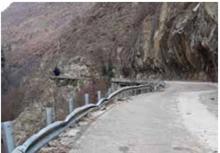
Die alte Talstraße im ersten Teilstück ca. 20 Jahre nach dem Bau des Tunnels. Die Aufnahme zeigt eindrucksvoll wie groß die Gefahr durch Steinschlag war.
